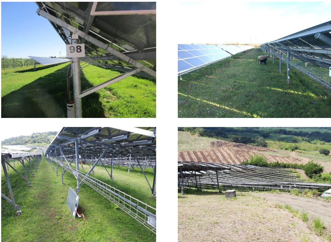
Figure 32. Photo 1 (printemps) et 2 (entrée automne) - Centrale Albioma Solaire Pierrelatte (Drome) ; Photo 2 et 3 (fin carême 2020) - Centrale solaire Albioma Solaire Lassalle de St Marie (Martinique).
